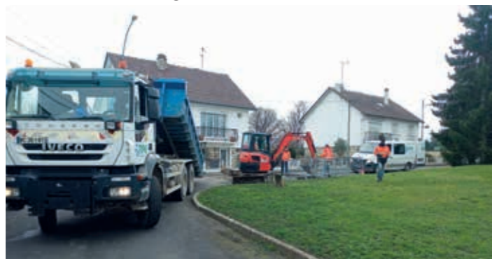
Avenue Beethoven, travaux suite à un effondrement de chaussée.
