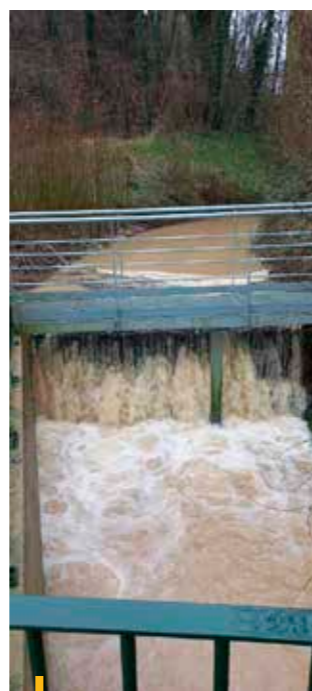
— Au Viaduc , entretien de la grille du déversoir de la Prédecelle et retrait des embâcles après de fortes pluies.
