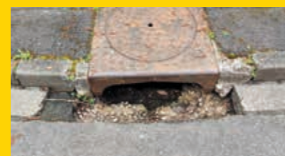
— Rue de la Brelandière , disparition de la grille de l'avaloir.
